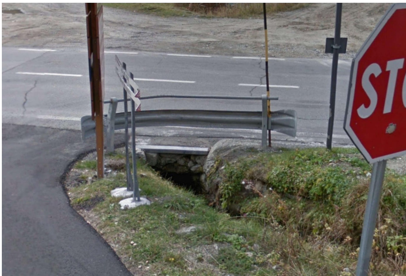
FOTO 3: particolare dell'attraversamento del T. de Mandaz a monte della Strada Regionale.
